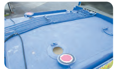
しょうか 消火ハッチ
