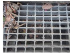
枯葉が溜まっている道路
