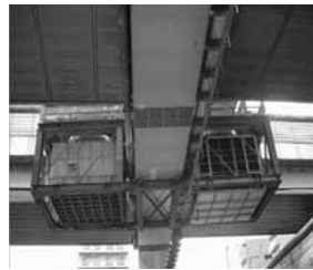
大型換気施設
