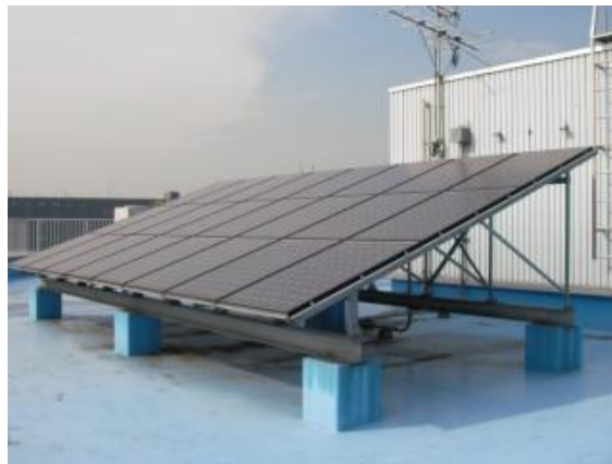
写真 4-1 太陽光発電設備(リサイクルプラザ屋上)
