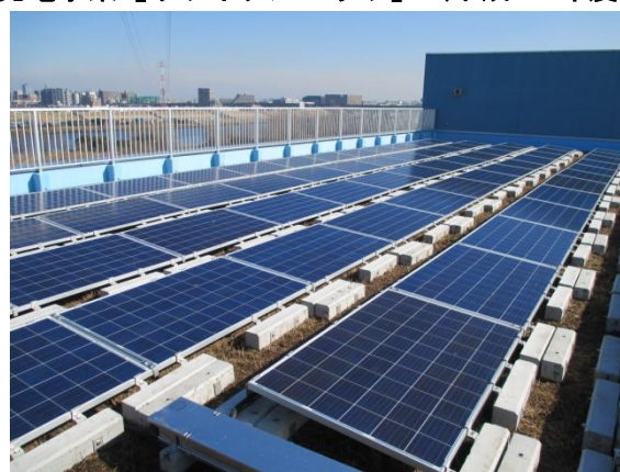
■ 太陽光発電システムの設置が完了したリサイクルプラザの屋上のようす
