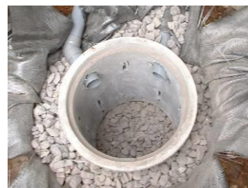
■ 雨水浸透ます
