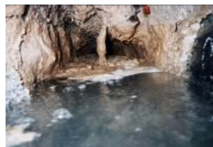
■ 油が付着した下水管内。固まった油はつまったり、悪臭の原因となる場合があります。（下水道局提供）
