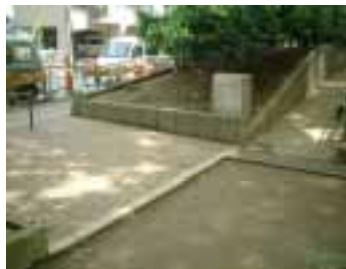
段差発生が発生したスロープ端部
