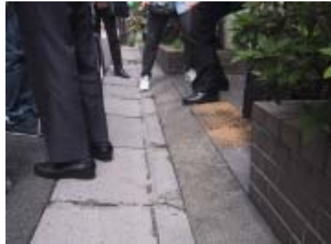
南常盤台一丁目集会所出入口部の段差
