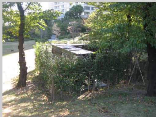
▲ 設備類の周囲に緑を配し、目立たなくしている／港区【③】
