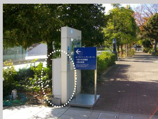
▲ 設備機器を歩道側から目立たないように、サインの後ろに隠している／目黒区【③】
