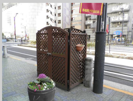
▲ 設備機器を木製の柵で囲い修景している／板橋区（板橋）【③】
