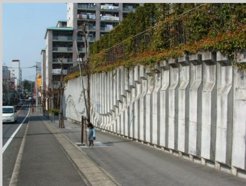
▲ 分割化や曲線のデザインを用いて長い擁壁面の単調さや圧迫感の軽減に配慮している ／川崎市【③】
