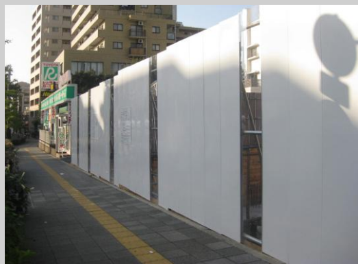
▲中の様子が見えるようにスリット部を設けている ／板橋区(成増)【②】
