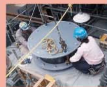
南館地下1階・柱上部に設置された免震装置。
