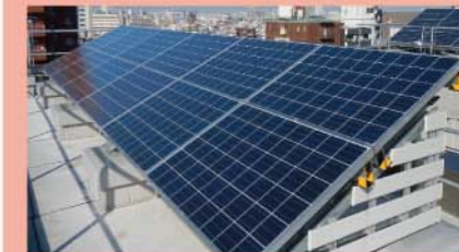
南館の外壁および屋上に取り付けられた太陽光パネル。各階で発電状況を表示。
