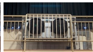
設置した空調機
