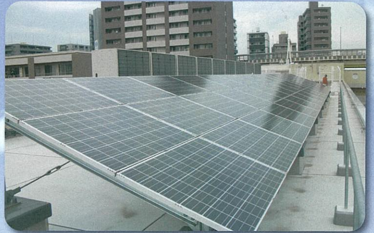
太陽光パネル
