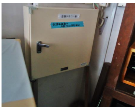
(空調リモコン盤)
