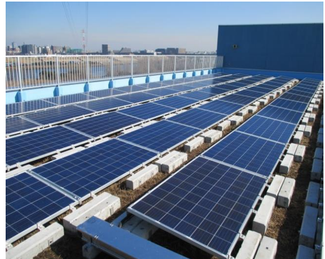
■ 太陽光発電システムの設置が完了したリサイクルプラザの屋上の様子
