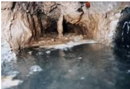
■油が付着した下水管内。固まった油はつまったり、悪臭の原因となる場合があります。（下水道局提供）
