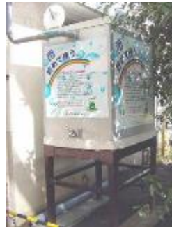
■ 雨水貯留タンク 桜川小学校
