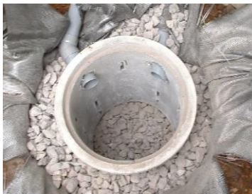
■ 雨水浸透ます
