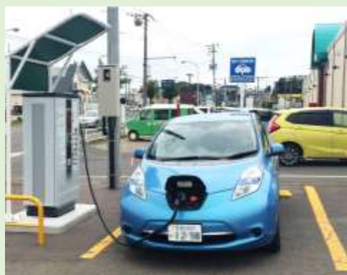
EV車と急速充電設備の事例
