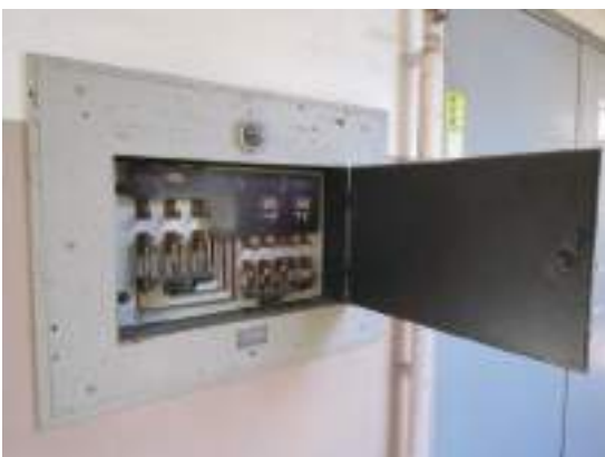
[図 38] 分電盤 昭和 16 年 10 月製造
