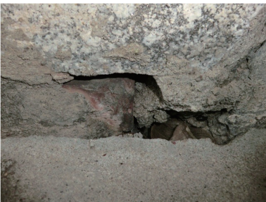
[写真 24] 7号室南側開口部沓石下のレンガ
