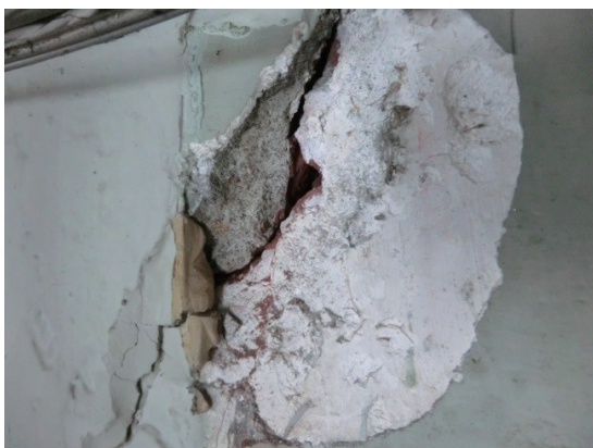
〔写真 33〕玄関 4 号室側の壁
