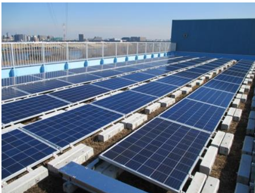
■太陽光発電システムの設置が完了したリサイクルプラザの屋上のような様子
