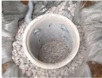
■ 雨水浸透ます
