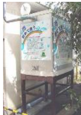
■ 雨水貯留タンク 桜川小学校
