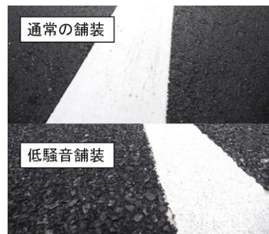
■低騒音舗装■ 車が走行する際の接地音やエンジン音の路面反射を吸収・低減させます。
