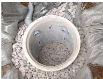
■ 雨水浸透ます
