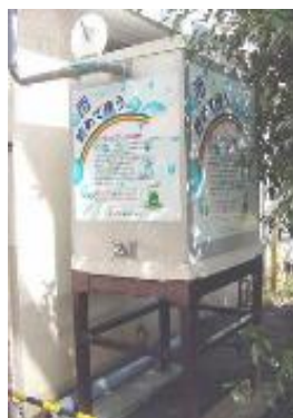
■ 雨水貯留タンク 桜川小学校
