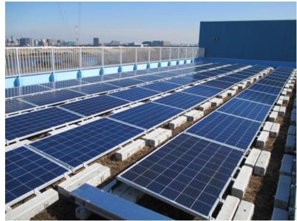
■ 太陽光発電システムの設置が完了したリサイクルプラザの屋上の様子
