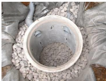
■ 雨水浸透ます
