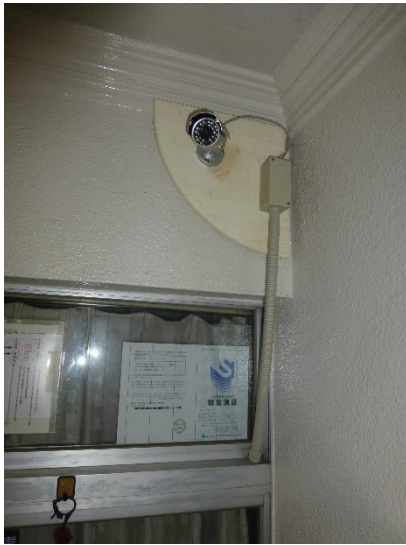
防犯カメラの設置
