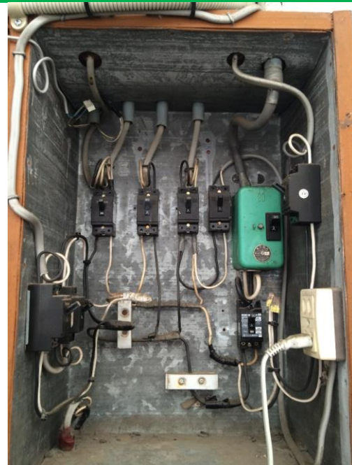
屋外に設置された 分電盤
