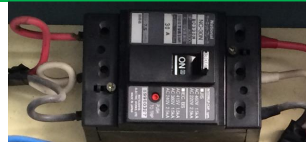
横向きに設置された ブレーカー
