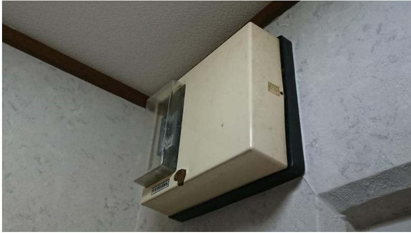
① ご家庭内の分電盤の設置場所を確認。
