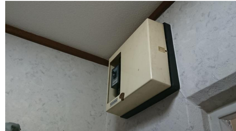
④ 分電盤の蓋を閉め、上記のような状態にします。
