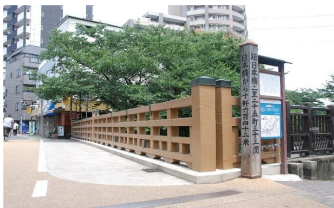
インフラ資産（板橋）
