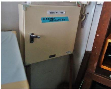
(空調リモコン盤)
