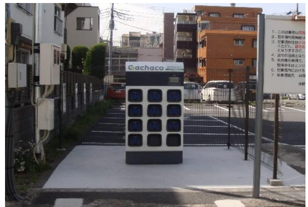
■バッテリー交換ステーション
