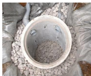
■ 雨水浸透ます
