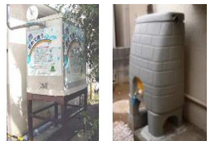
■ 雨水貯留タンク
