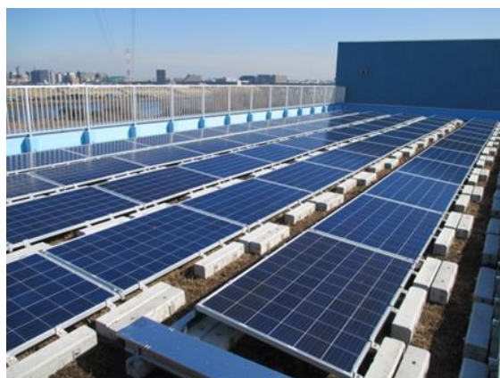
■太陽光発電システムの設置が完了したリサイクルプラザの屋上の様子
