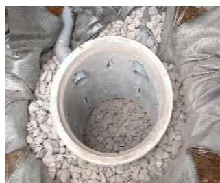
■ 雨水浸透ます
