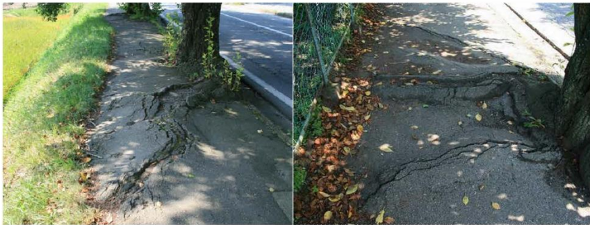
写真 舗装部の根上がり 8)
