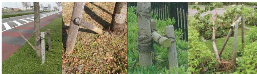
写真 支柱の損傷 3)
