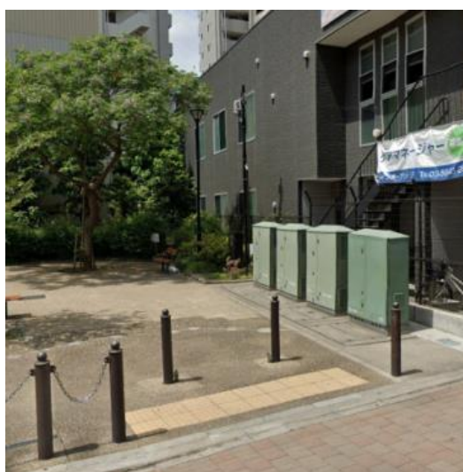
■沿道の公園に設置した事例 板橋宿不動通り商店街（板橋区）
