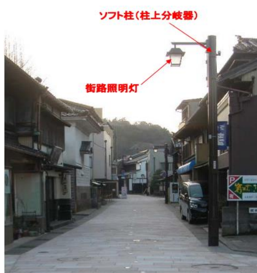
■景観に配慮した地上機器の整備事例 （石川県金沢市）
