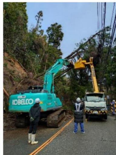
石川県穴水町 県道303号
